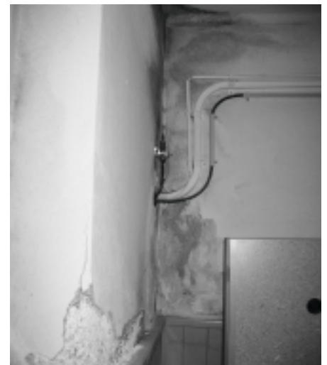
Die Schäden im Schulhaus Heiligkreuz sind nicht zu übersehen.
