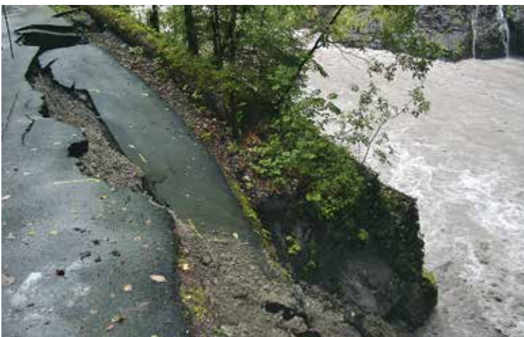
Die Seez spült den Böschungsfuss aus, und in der Folge rutscht die Böschung ab.
