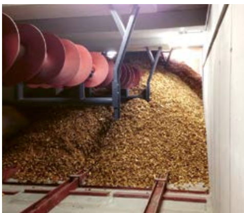
Beispiel: Wärmeverbund Feldacker (Holzschnitzel)
