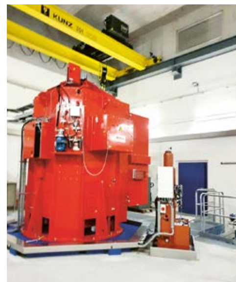
Turbine KW Steigs: Inbetriebnahme 2014, Leistung 3300 kW.
