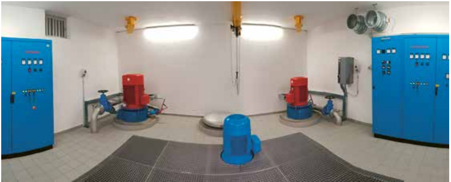
Blick ins Innere des Betriebsgebäudes im Schattenberg: Hier sind die Anlagen Luterbach-Sässli und Verlorener Brunnen untergebracht.
