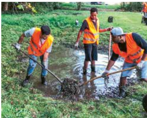
Arbeitseinsatz: Die Asylanten der Gemeinde Mels entfernen unter der Leitung von Marc Cathomen Erdmaterial.
