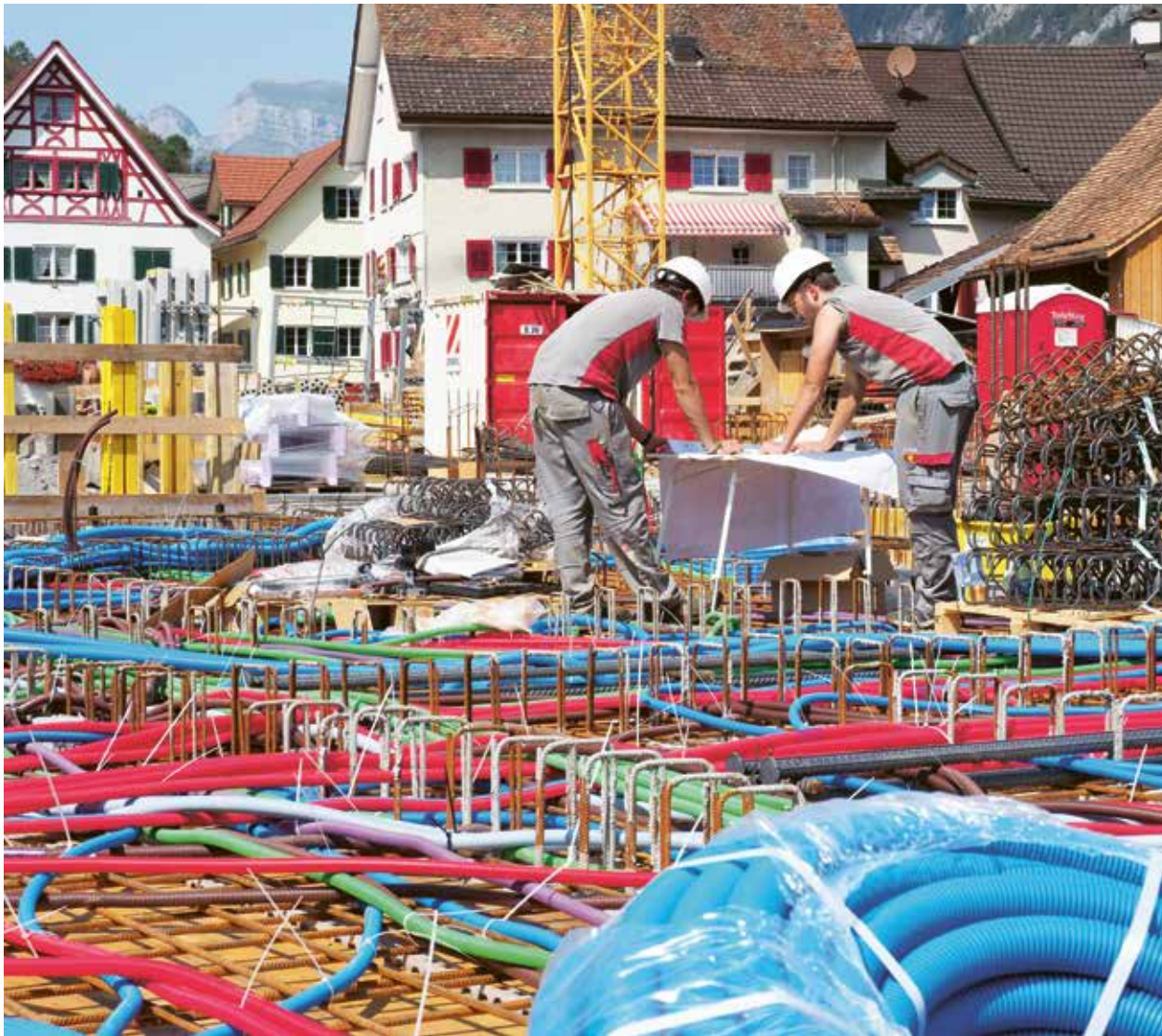
Farbenfroher Anblick: Kabel und Leitungen, so weit das Auge reicht.
