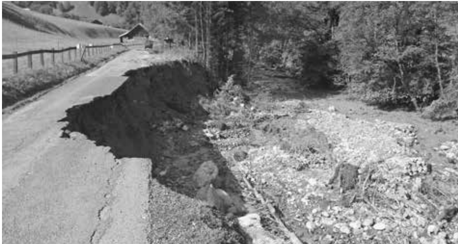
Zerstörerischer Gufelbach: Die linksseitige Böschung entlang der Gschwendstrasse wurde stellenweise weggerissen, die Strasse beschädigt.
