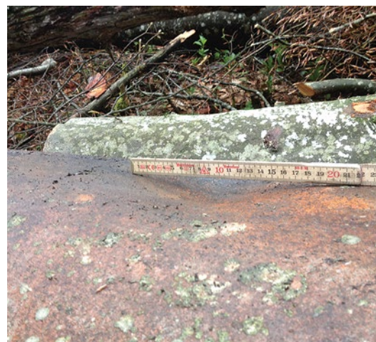
Windwurfholz schlug Dellen in die Druckleitung.
