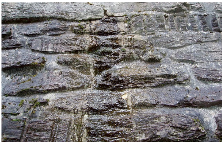
Wasserverlust Staumauer Nord.
