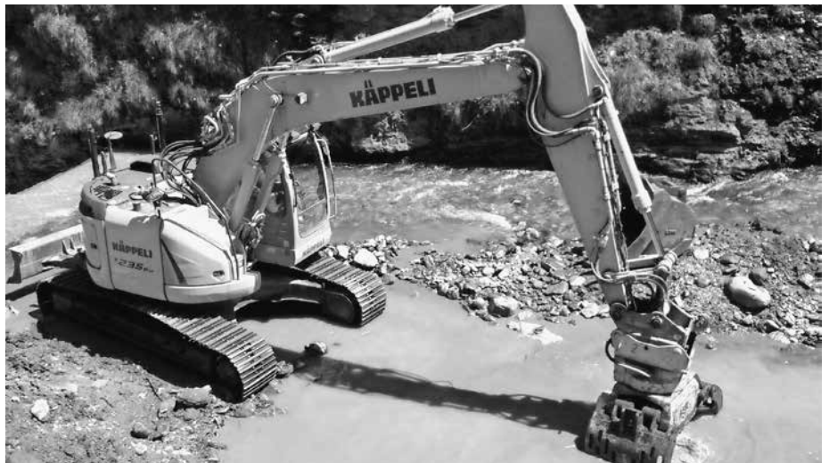
Uferverbauung Seez bei Esel-Samichlaus
